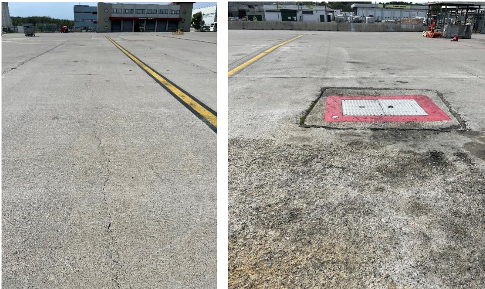
Figura 23: Esempio di fessura longitudinale (foto di sinistra) e presenza di un pozzetto (foto di destra) ispezionate durante il sopralluogo del 13/09/2022.
